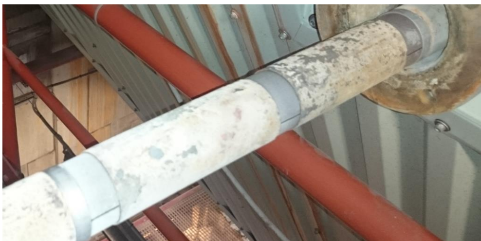
Figur 11 Korrosionssonden efter korttidstestet. De tre sondringarna var 125, 100 och 75°C respektive, räknat från höger.
