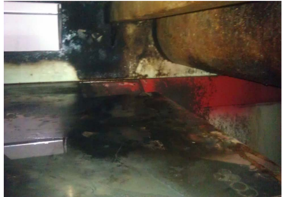
Området sanerat där det tydligt syns var branden startat
