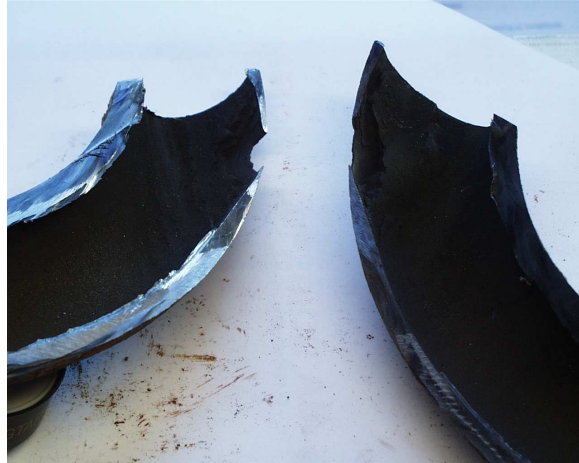
Erosionsskada i rörböj
