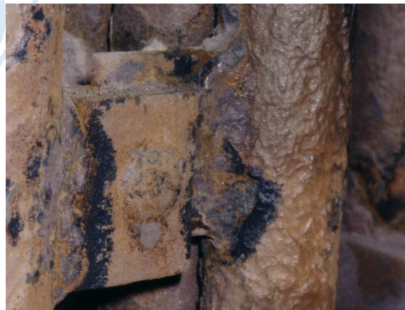
Högtemperaturkorrosion på överhettare
