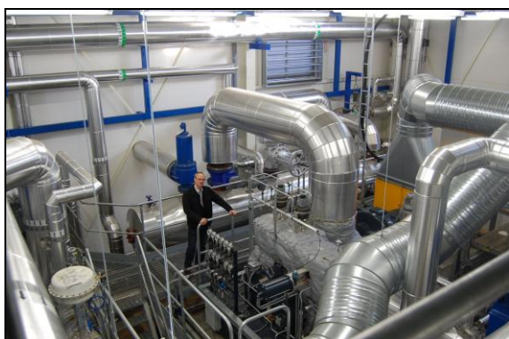
Jörgen Karlsson, vd på Munkfors Energi framför ny ångturbin och generator. Foto: Munkfors Energi
